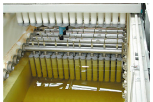
浸漬型膜ろ過槽内部(膜モジュール576本)
