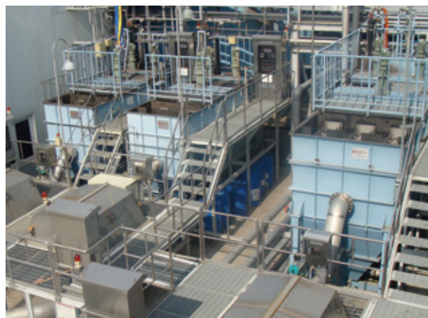
懸濁排水・回収処理システム(半導体工場)
