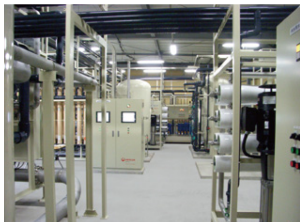
懸濁排水・回収処理システム(自動車工場)
