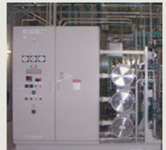
酸素原料オゾン発生機
